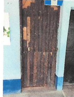
Foto 2: Se necesitan puertas de metal
